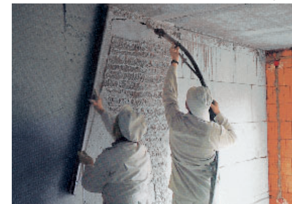
La MP 25 es verdaderamente flexible. En la foto durante un enfoscado normal.
